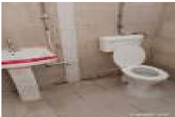
CWSN TOILET PHOTO
